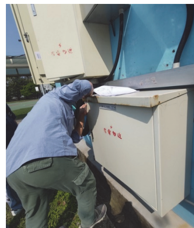
配電盤箱體鏽蝕無法開啓
