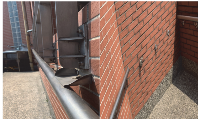
扶手壁面有突起物或損壞未修繕
